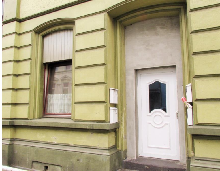
Negatives Beispiel: Hauseingang und Fensteröffnung wurden verkleinert, um Standardtür und kleinere Fenster einbauen zu können
