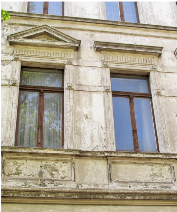
Erneuerungsbedarfe lassen sich tw. bereits an der Fassade ablesen
