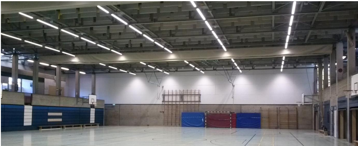
Abbildung 32 – Sporthalle mit Beleuchtungserneuerung
