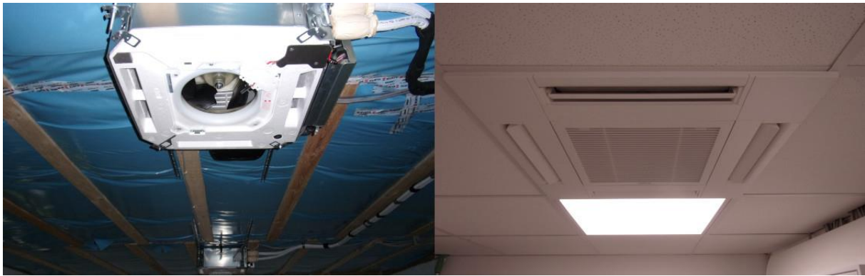
Abbildung 31 - Deckenkassetten der Wärmepumpe
