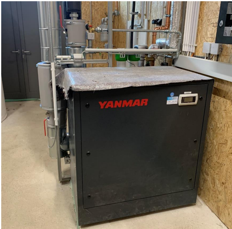
Abbildung 22 - Wärmetauscher und 1.500 l Pufferspeicher (nicht auf Abb.) zur Übergabe an Fußbodenheizung
