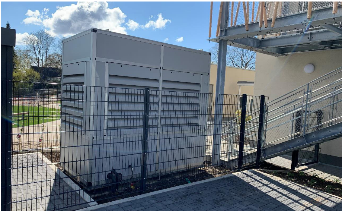
Abbildung 21 - Luft-Wasser GMWP zum Heizen und Kühlen
